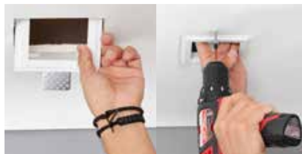
2 - Introduce el luminario y sujétalo con pijas
